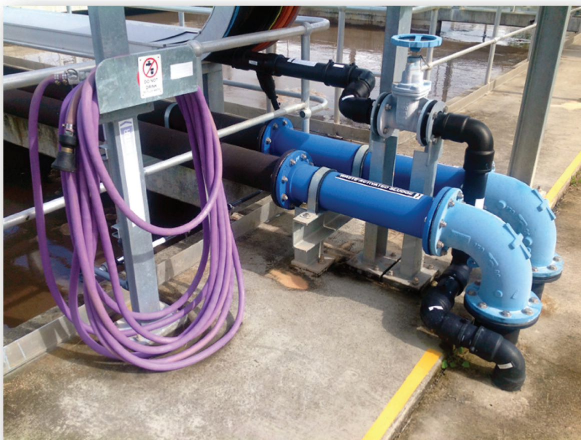
以明顯標識區分自來水管與再生水管
